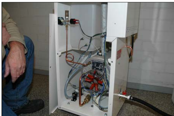
Figure 1 Intérieur chaudière à vapeur
