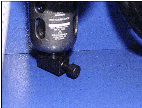
Figure 18 Vidange de l'eau de condensation
